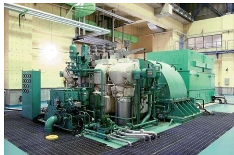
資源循環局金沢工場の蒸気タービン発電機
